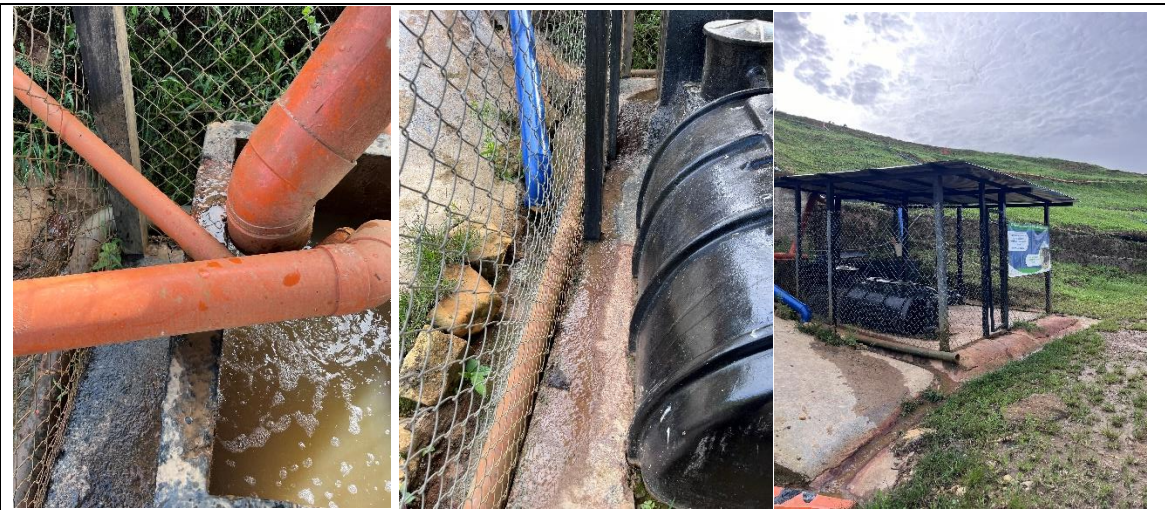
Anexo 10. Vertimiento de lixiviados por fuera del sistema
