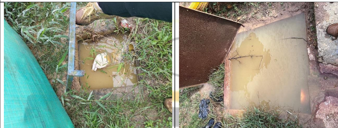
Anexo 11. Falta de mantenimiento en cajas de lixiviados y aguas lluvias.
